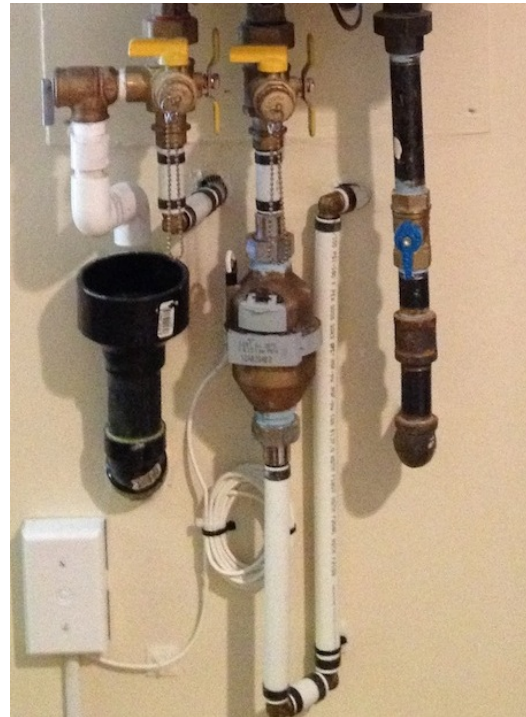
(d) Hot Water Meter
